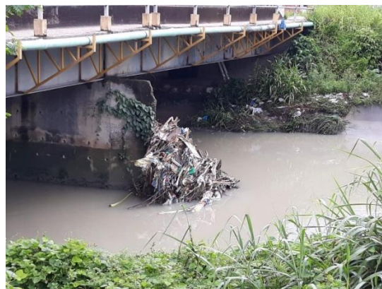
Figura 10: Depósitos tecnogênicos a montante de pilares de pontes
