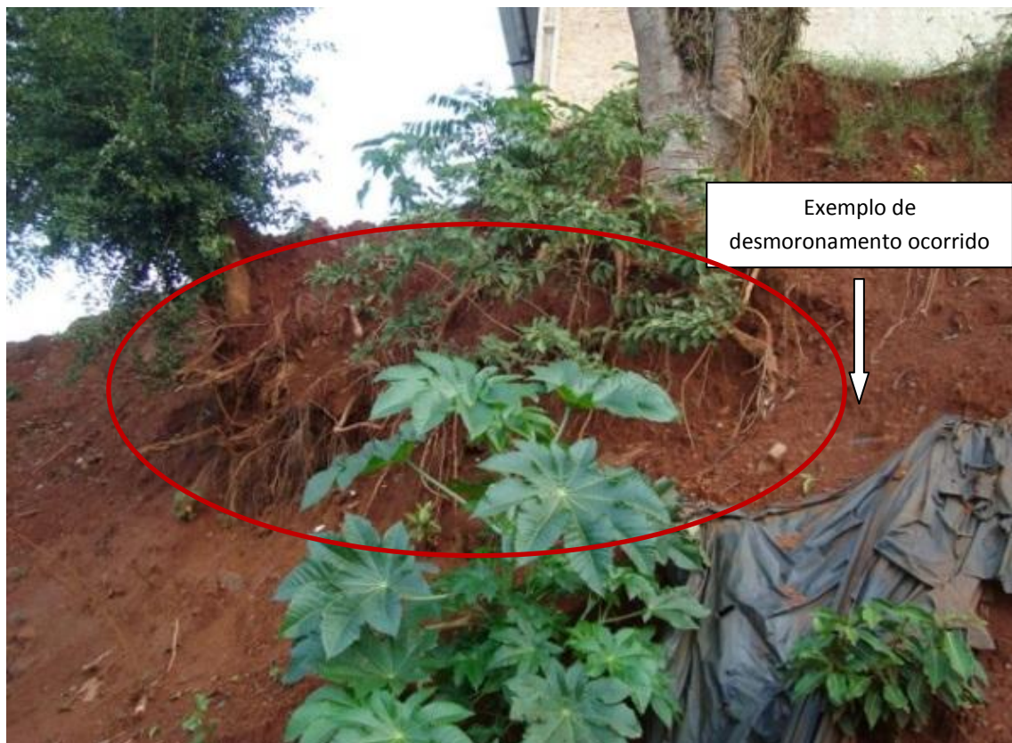
Figura 5 - Situação da área no ano de 2014, evidenciando escorregamentos da massa de solos.
