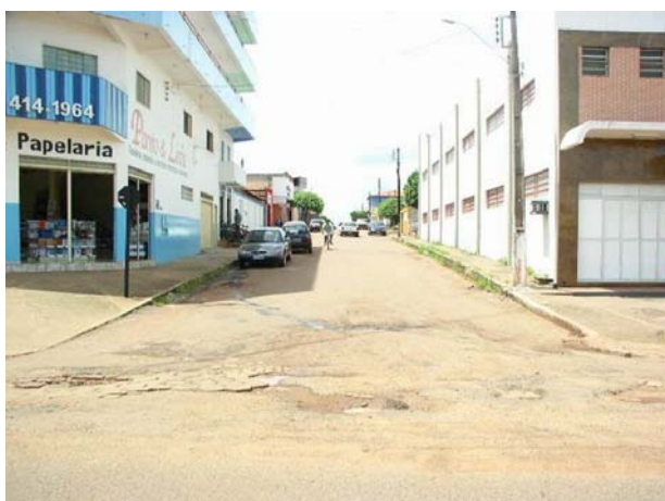
Figura 12. Pavimentação asfáltica danificada pelas enxurradas, na rua Recife do Setor Brasil em Araguaína - TO. Fonte: Secretaria de Obras e Serviços Urbanos de Araguaína - TO (2005).
