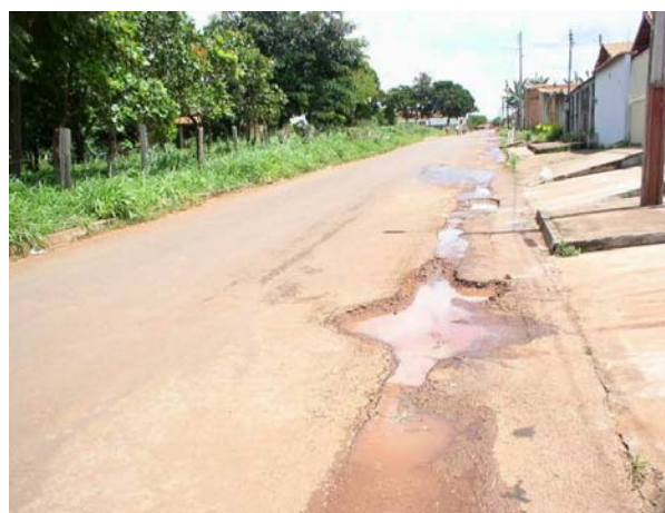
Figura 13. Pavimentação asfáltica danificada pelas enxurradas, na rua Anchieta do Setor Noroeste em Araguaína - TO. Fonte: Secretaria de Obras e Serviços Urbanos de Araguaína - TO (2005).
