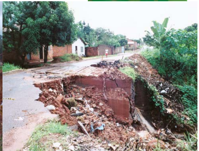
Figura 10. Ponte comprometida na rua São Paulo (córrego Cará), ligando o setor Eldorado com o Setor Carajás, em Araguaína - TO. Fonte: Secretaria de Obras e Serviços Urbanos de Araguaína - TO (2005).
