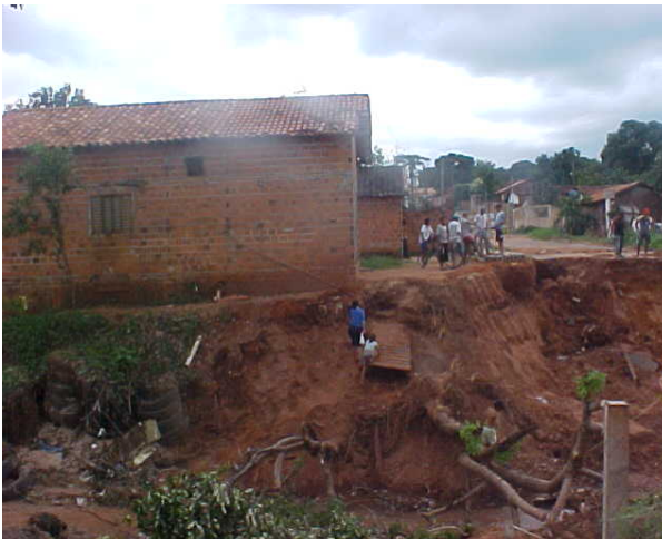
Figura 9. Casa comprometida próximo ao Córrego Cará no Setor Carajás, em Araguaína - TO. Fonte: Secretaria de Obras e Serviços Urbanos de Araguaína - TO (2005).
