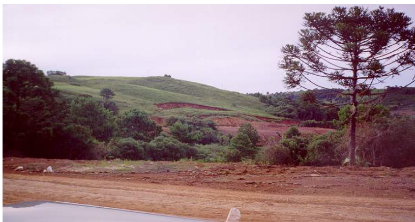
Figura 10 – Movimento de massa no 2º Trecho da BR 282
